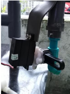
Gambar 8. Posisi Kran Tertutup Saat Tidak Hujan.
