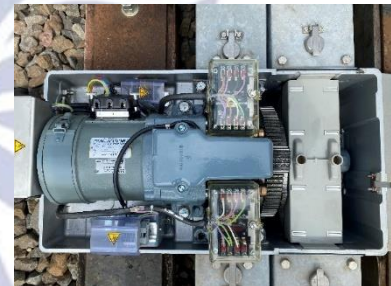
Gambar 3 Motor wesel Siemens BSG-9
