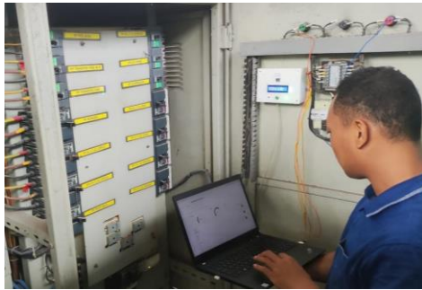
Gambar 5. Implementasi prototipe pada panel capacitor bank
