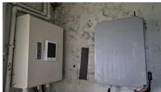
Gambar 6 Box Kontrol PLTS
