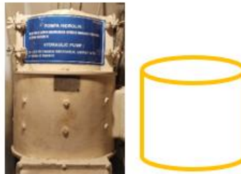
Gambar 9. Tabung pada Pompa Hidrolik
