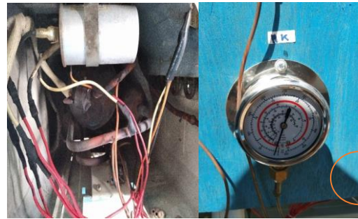
Gambar 5 Letak sensor dan manometer tekanan tinggi
