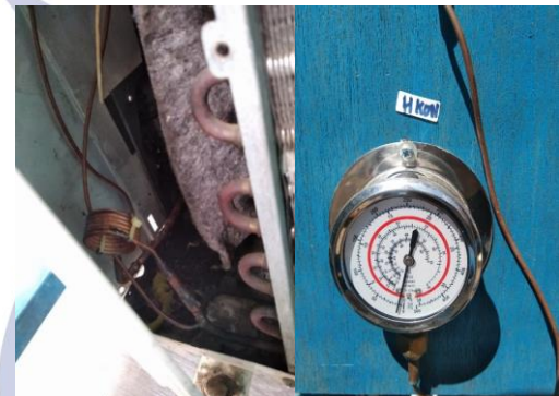
Gambar 6 Letak sensor dan manometer tekanan tinggi
