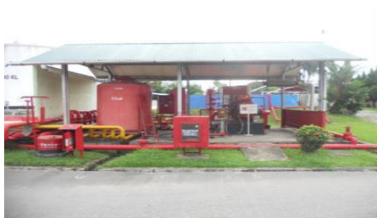
Gambar 4.15 Rumah Pompa Pemadam Kebakaran
