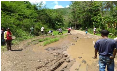
Gambar 1.2 Kondisi Jalan Lingkungan Desa Lewomada Sebelum Dibangun
