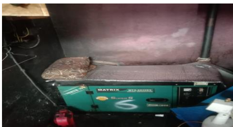
Gambar 7. Kerusakan Komponen Genset
