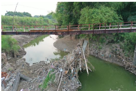
Gambar 1. Kerusakan Jembatan Talun Brak
