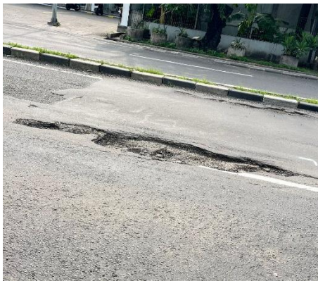
Gambar 1. 1 Kondisi Jalan Berlubang
