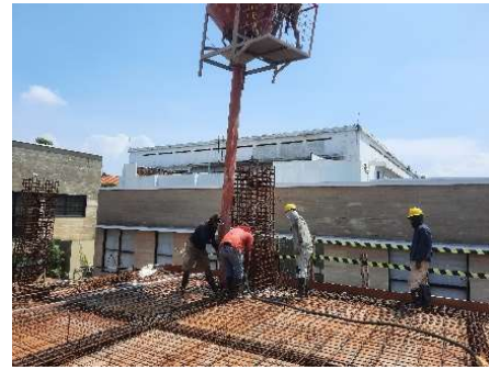
Gambar 3. Pekerja tidak memakai APD lengkap saat pengecoran kolom
