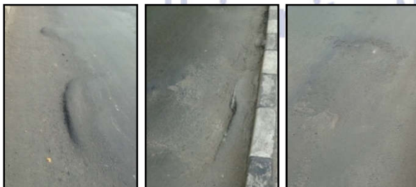
Gambar 1 Kondisi Kerusakan Jalan Sumber: Dokumentasi Lapangan
